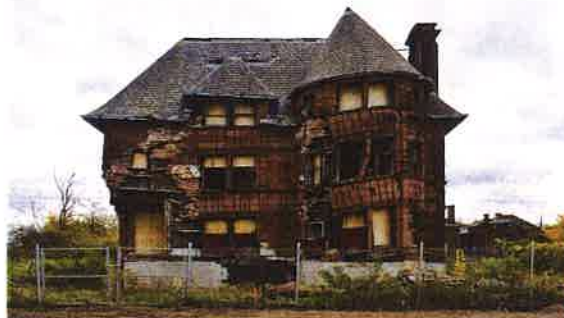
Bâtiment non entretenu au bout de 99 ans
